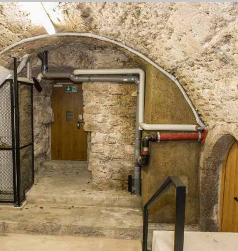
Durchfeuchtete Gewölbe unterhalb der Burgküche
