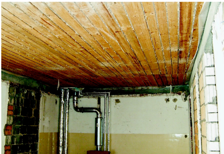
Hinter der Holz-Lattung ist eine Dampfsperre eingebaut, die dahinter eingebrachte Zelluloseflockung war feucht oder sogar nass. Infolge kam es in diesem Bereich zu Schimmelpilzbildung.
