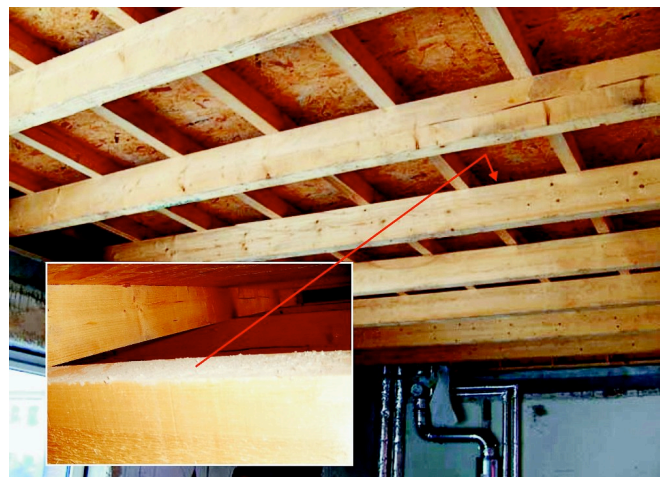
Die Reinigung auf der Oberseite der Sparren wurde übersehen. Dies führte zu dem zuerst schlechten Sanierungsergebnis.
