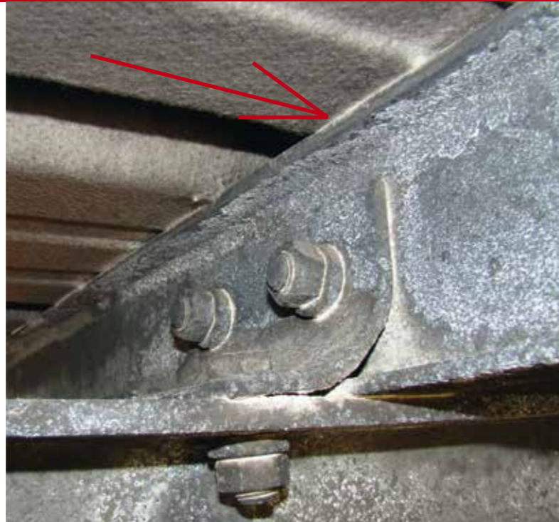
Die Korrosion schreitet voran
