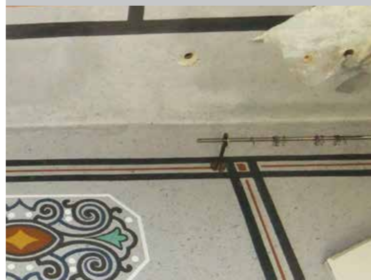
Die aufwendig gestaltete Hoteldecke war großflächig durchfeuchtet
