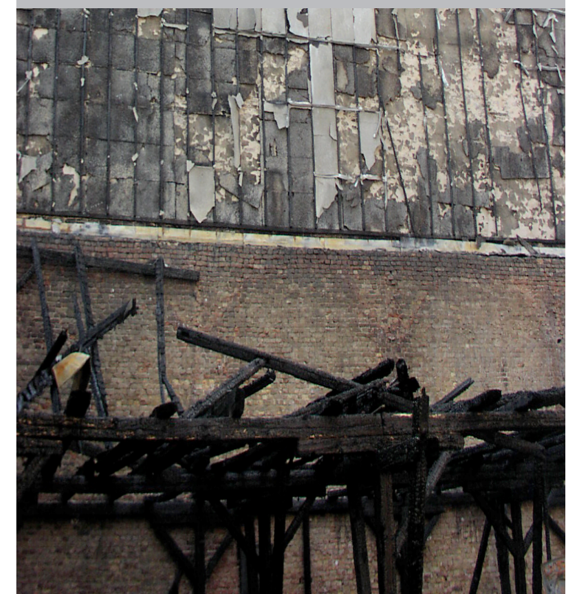
Durch einen Brand zerstörte Asbestzement-Fassade
