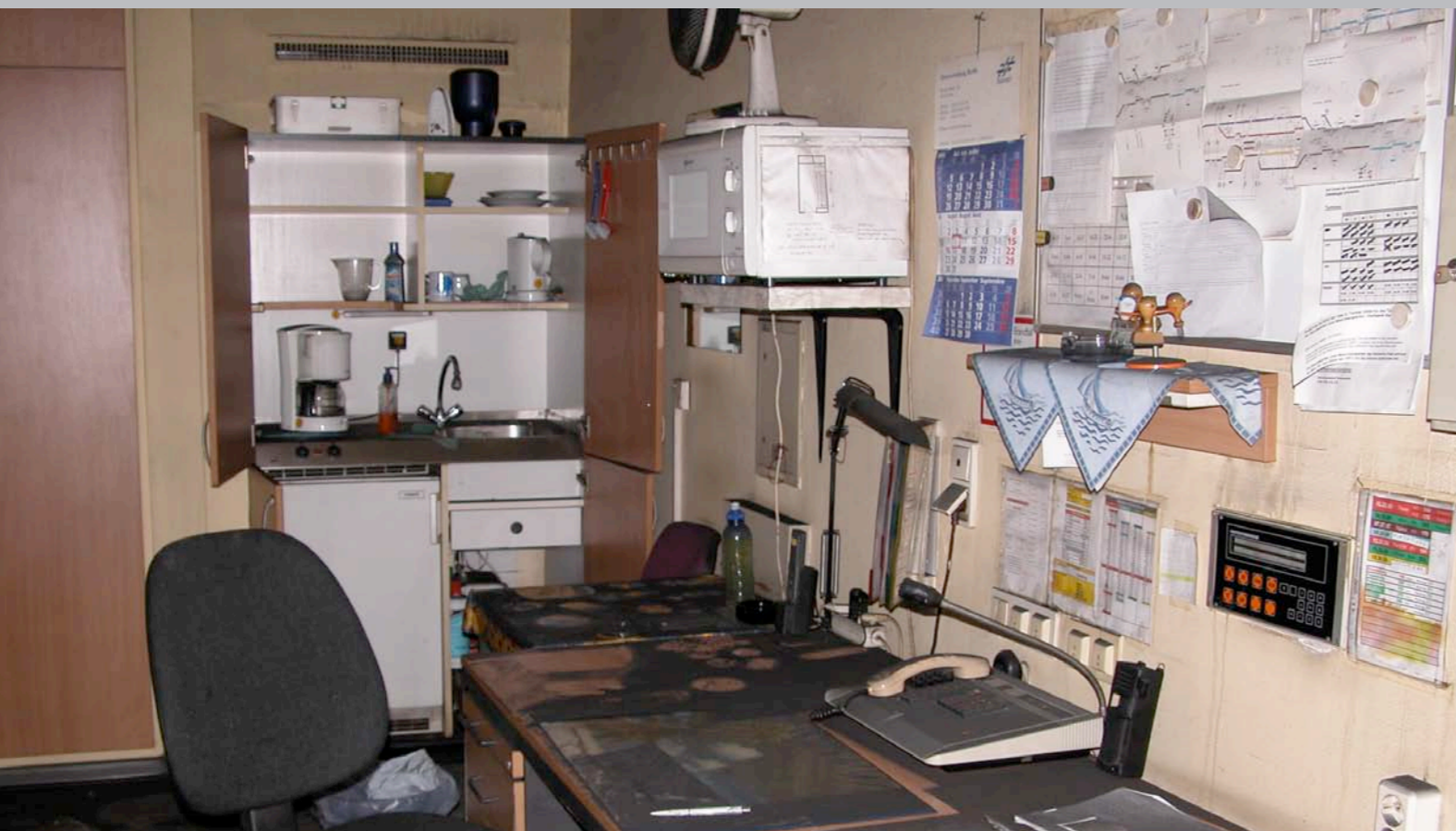
Durch Brandkondensate „verunreinigte“ Büromöbel (Kontaminierte Bereiche gemäß BGR 128)
